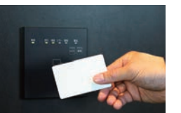
非接触式ICカードシステム
